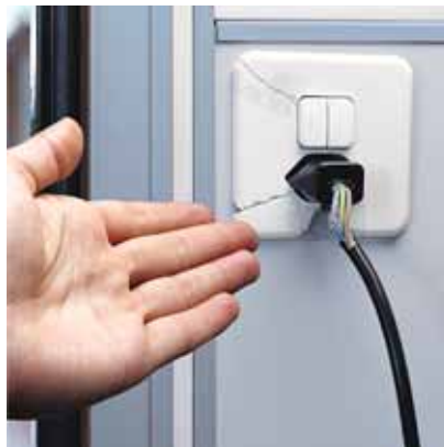
Fig. 2: copertura difettosa, rischio di elettrocuzione
