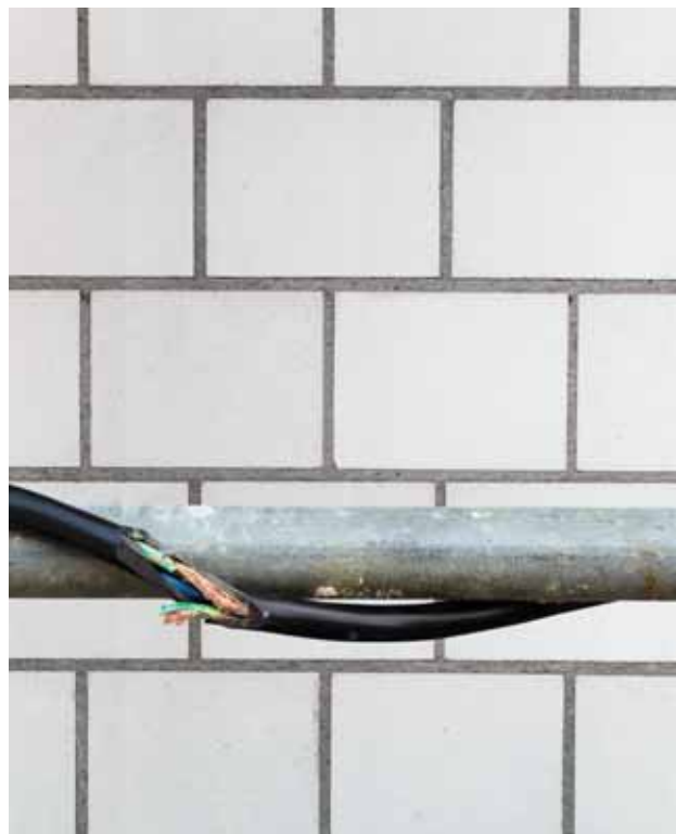
Fig. 16: usare apparecchi con cavi danneggiati è sempre pericoloso
