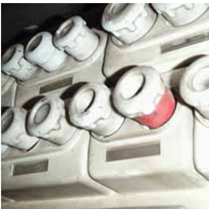
Fig. 1: elemento in ceramica difettoso, rischio di elettrocuzione
